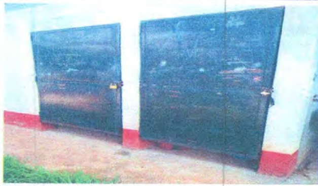
Foto 1: Sustrucción de puerta en servicios sanitarios
